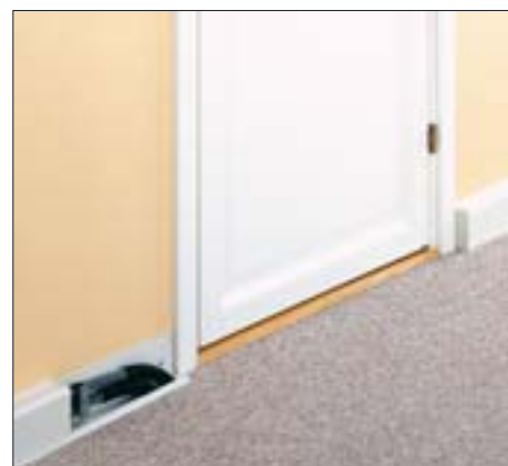
39. Dørunderføring under gulv i tomrør.
