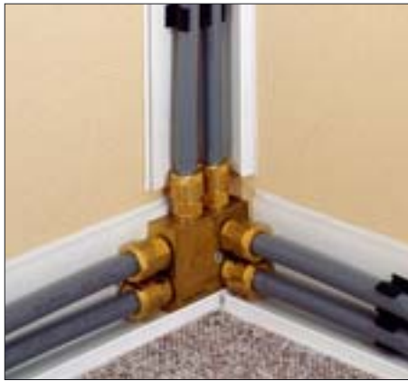
41. Colombusæg monteret i hjørne ved gulv.
